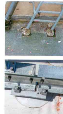
† † Ein vorprogrammierter Dachschaden.
