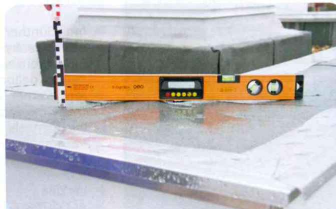
Im Eckbereich überlagern sich die Abdichtungsbahnen vierfach. Und so sieht das Ergebnis schließlich aus.
