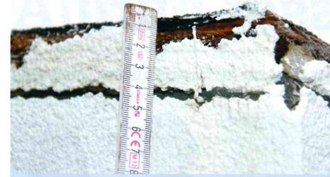
Die 25 mm dicken OSB Platten sind auf ca. 40 mm aufgequollen, da stirnseitig der Witterung über eine längere Zeit ausgesetzt.
