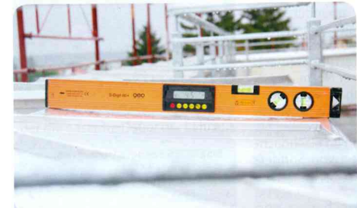
Sieht auf den ersten Blick gut aus, doch die Sutte ist auffällig und an der Traufe zur Tropfnase hin steht bereits das Wasser.
