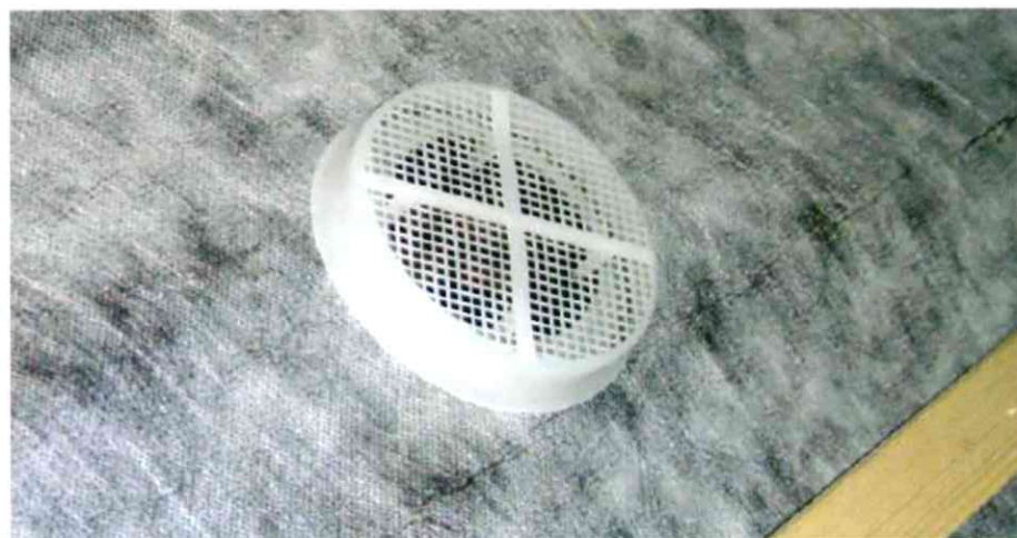
Dachböden / Dachbodenräume und deren nicht durch Dachausbau genutzten Bereiche (z.B. Spitzböden, Dachzwickelräume) sind zu belüften. Geändert hat sich auch der Belüftungsquerschnitt firstseitiger Abluftöffnungen bei Dacheindeckungen mit „großem“ Fugenteil, wie Dachsteinen und Dachziegeln, welche in Einfachdeckung verlegt werden.
